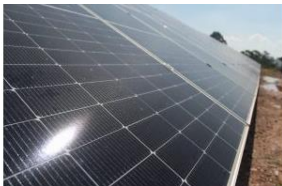
Usina Fotovoltaica. Foto: Alex Cavanha/PMSA
