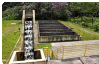
Estação de Tratamento de Esgoto Parque Andreense
