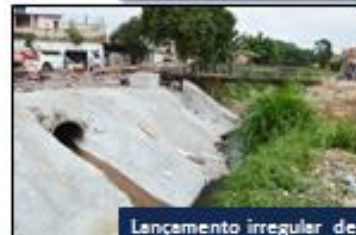
Lançamento irregular de esgoto
