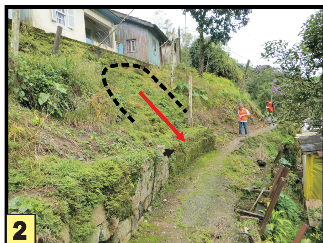
2 Talude instável, com plano de ruptura e cicatriz de deslizamento ocorrendo, muro de contenção abaulado devido ao peso do solo
