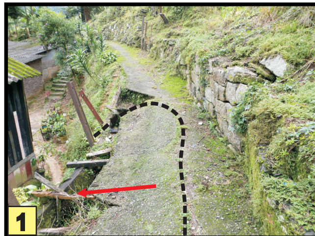
1 Acesso com trincas e com abatimento devido a deslizamento de talude
