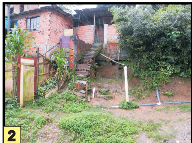
Movimentação do solo com perda de base de sustentação da casa.
