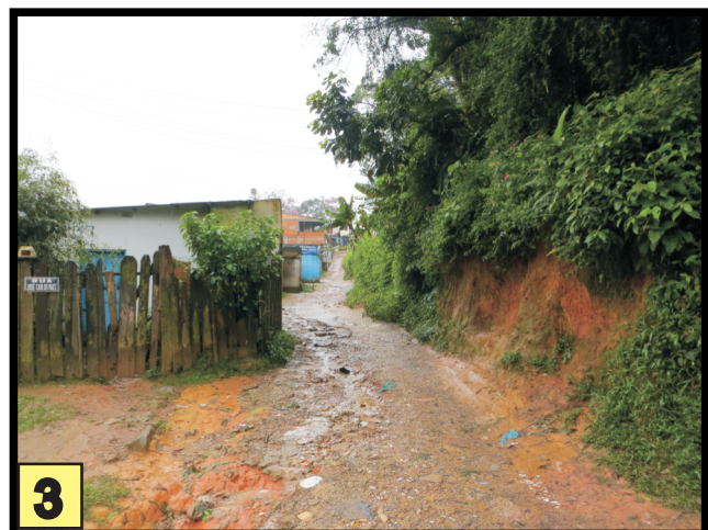
Ausência rede de escoamento de águas pluviais.
