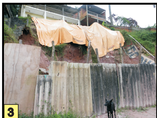
3 Deslizamento de solo na parte da frontal da residência.
