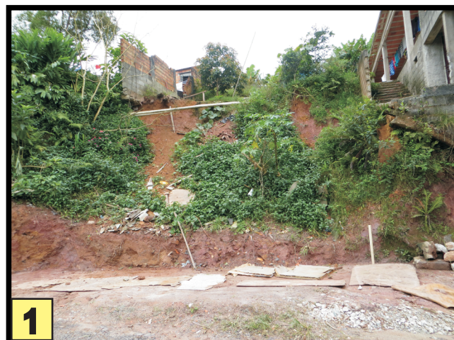
1 Deslizamento de solo na Rua Mico Leão Dourado onde uma residência e um muro correm risco de desabamento.
