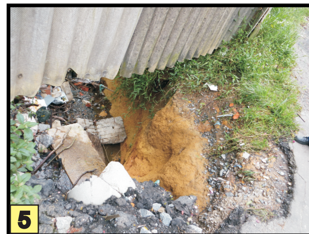
Ravinamento como indicio de erosão por enxurradas.
