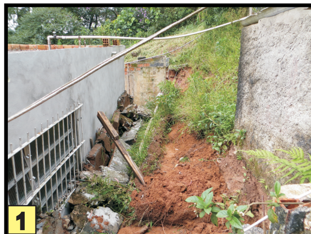
Desmoronamento de terra atingindo muro e fundos de moradia
