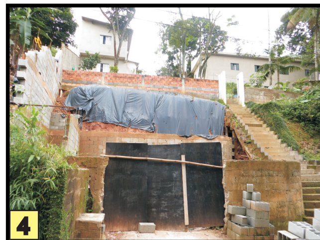
Corte subvertical para ganho de terreno plano, colocando em risco a moradia situada na parte superior da encosta.
