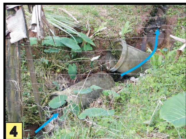
4 Tubulações rompidas devido ao excesso de volume de água.
