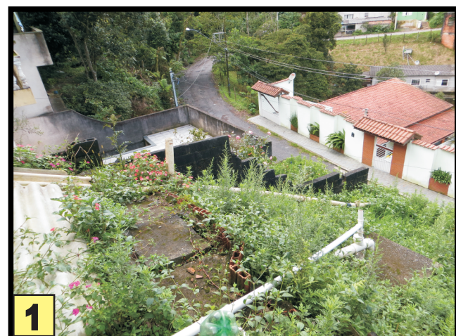
1 Moradia em encosta inclinada, com muro de gabião aos fundos em processo de "embarrigamento", presença de fossas, trincas e degrau de abatimento.
