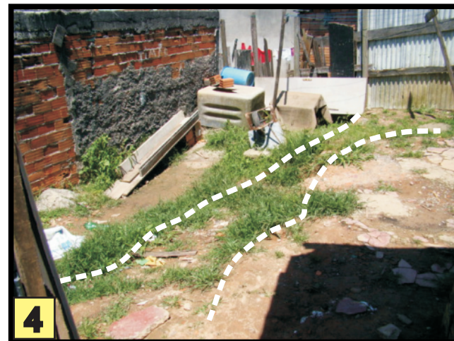
4 Terreno com degraus de abatimento, evidenciando instabilidade do solo
