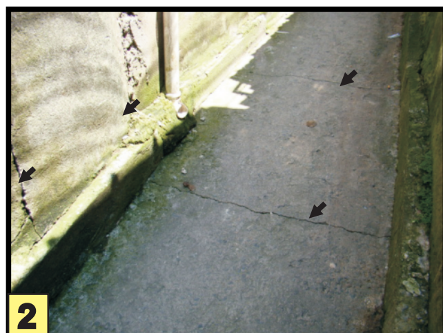
2 Trincas no pavimento e paredes de moradias, evidenciando instabilidade do solo da região
