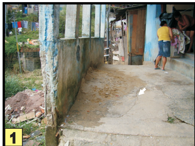
1 Moradia com trincas no piso e sinais de movimentação do solo de aterro.
