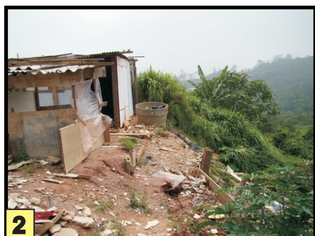
2 Moradia de construção vulnerável, sobre aterro de resíduos domésticos e de construção civil ainda instável.
