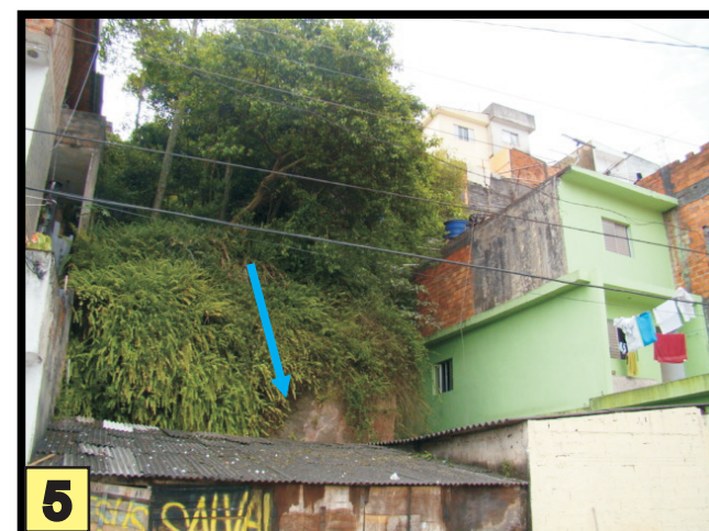
5 Talude de corte vertical, muito alto risco de deslizamento de solo.
