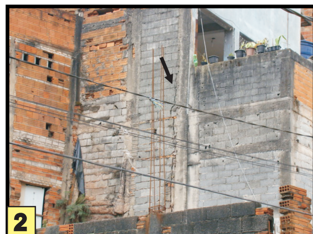
2 Moradia com trinca, evidenciando intabilidade e movimentação do solo.
