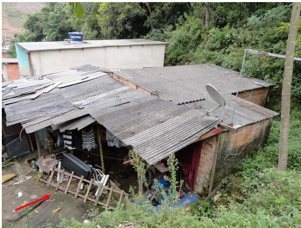
Foto FC-STA-22-01.01: Detalhe de uma das moradas do setor muito próxima a base do talude de corte. Na frente da moradia, sob as placas de madeira (seta vermelha) passa um pequeno córrego.
