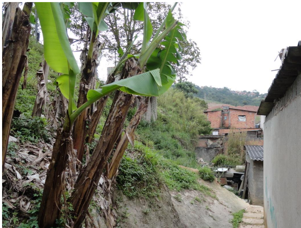
Foto FC-STA-23-02.01: Vista das moradias localizadas na base do talude. Notar a proximidade destas com a mesma.
