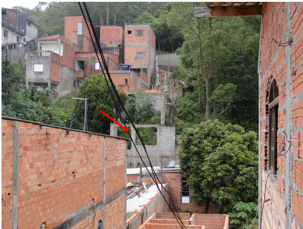
Foto FC-STA-20-02.02: Vista parcial do setor. Na moradia indicada com a seta vermelha foi observado um depósito de material mobilizado por um deslizamento.
