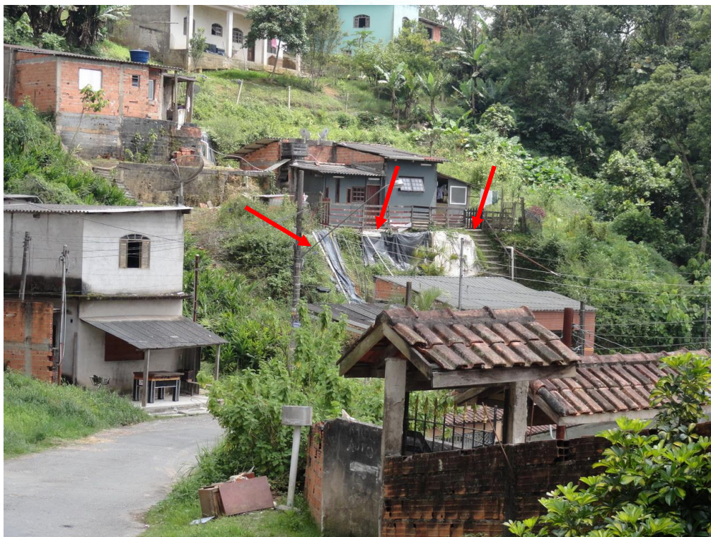
Foto FC-STA-24-01.02: Vista parcial do setor. Notar as lonas plásticas pretas e branca (setas vermelhas) cobrindo cicatrizes de deslizamento.
