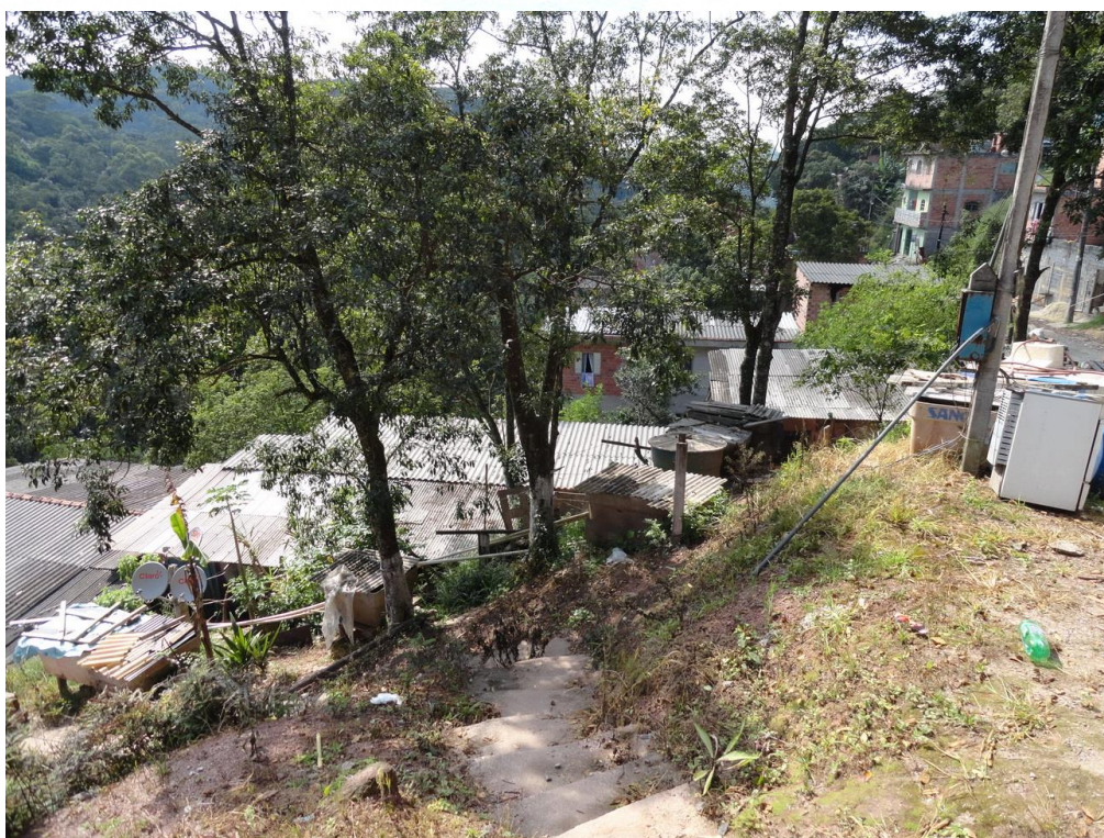
Foto FC-STA-27-01.02: Notar a distância das moradias com relação a base do talude de corte e a presença de árvores inclinadas no topo do talude.
