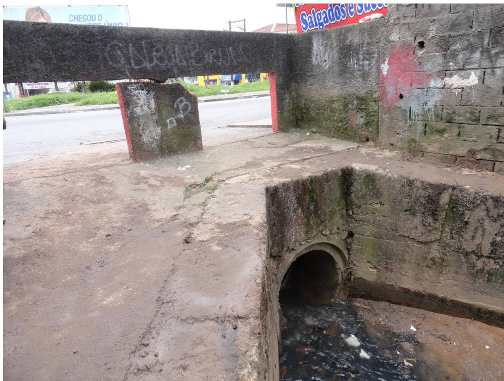
Foto FC-STA-23-01.01: Detalhe do tubo localizado a jusante da área, o qual é subdimensionado para o volume da água das quando da ocorrência de fortes chuvas.
