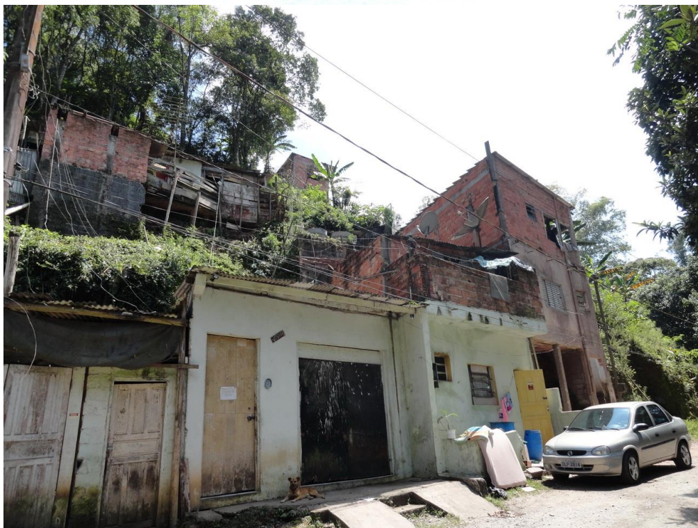
Foto FC-STA-29-01.02: Detalhe de um dos taludes de corte do setor. Notar a proximidade das moradias com relação ao seu topo e base, e sua altura elevada.
