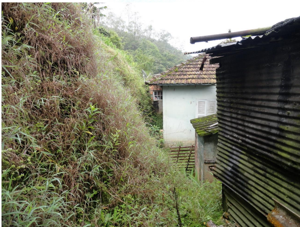
Foto FC-STA-32-02.02: Detalhe da proximidade das moradias com relação a base de um dos talude de corte presentes no setor.
