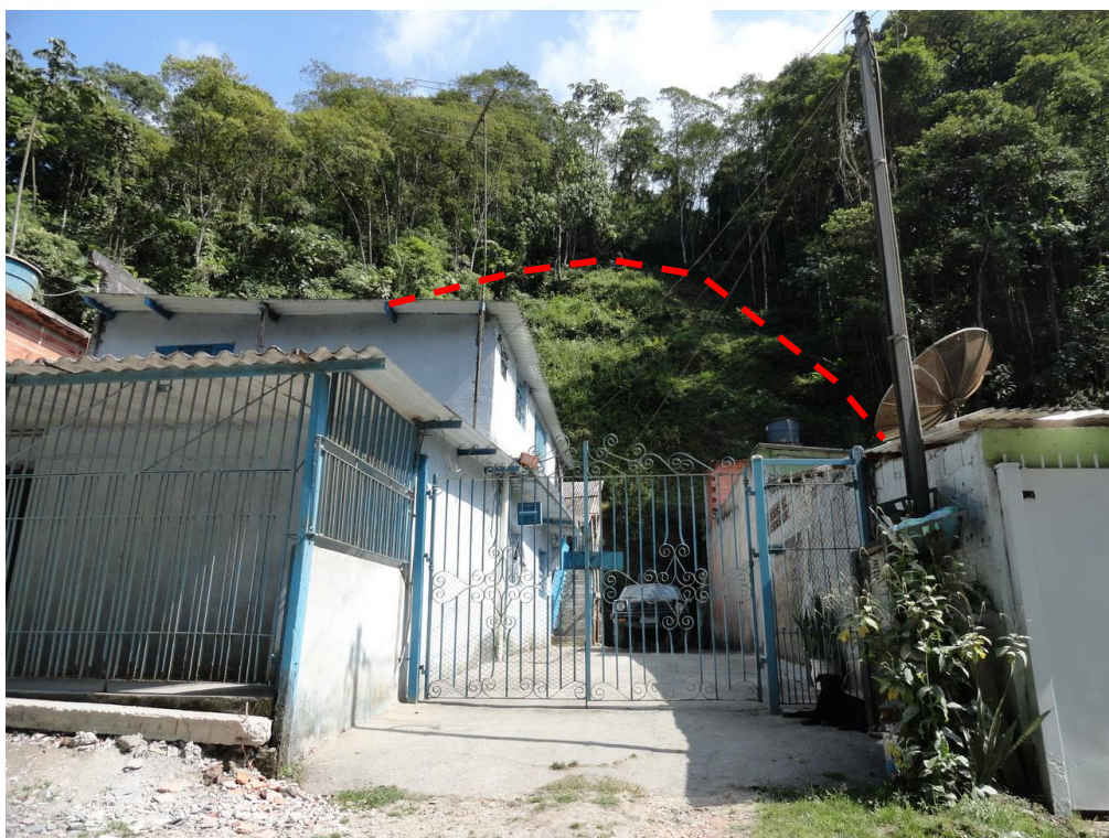
Foto FC-STA-30-01.02: Detalhe da cicatriz de deslizamento (tracejado vermelho) nos fundos de uma das moradias do setor.
