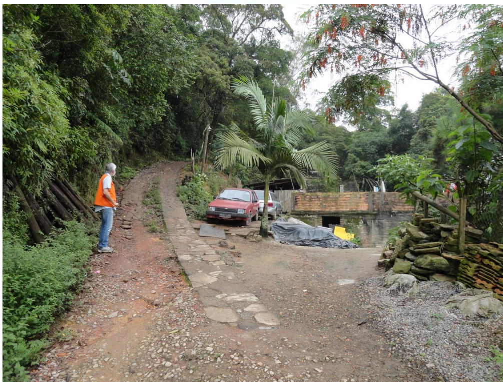
Foto FC-STA-32-01.02: Detalhe da ausência de sistema de drenagem e da baixa a média inclinação do setor.
