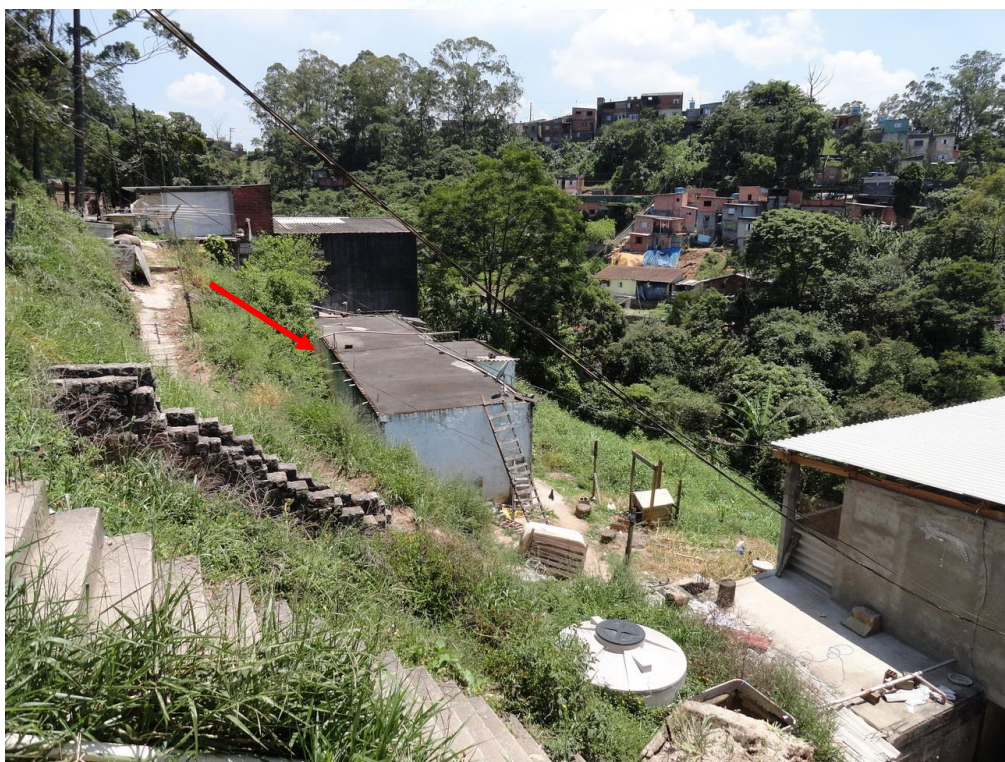
Foto FC-STA-28-01.02: Detalhe da proximidade das moradias com relação a base de uma dos taludes de corte do setor (seta vermelha).
