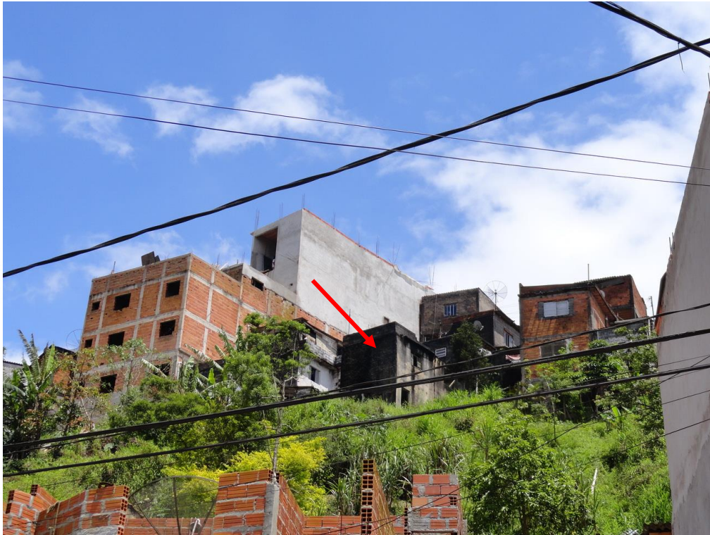
Foto FC-STA-19-02.01: Notar a altura e inclinação elevada da encosta e dos taludes. A seta vermelha indica uma moradia no topo da encosta, a qual apresenta diversas trincas e um degrau de abatimento em sua base.
