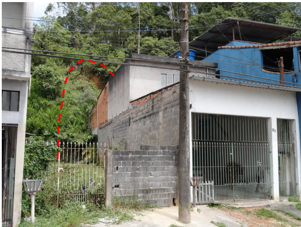
Foto FC-STA-26-01.01: Detalhe da cicatriz de deslizamento nos fundos de uma das moradias do setor, em um talude de corte com altura e inclinação elevadas.
