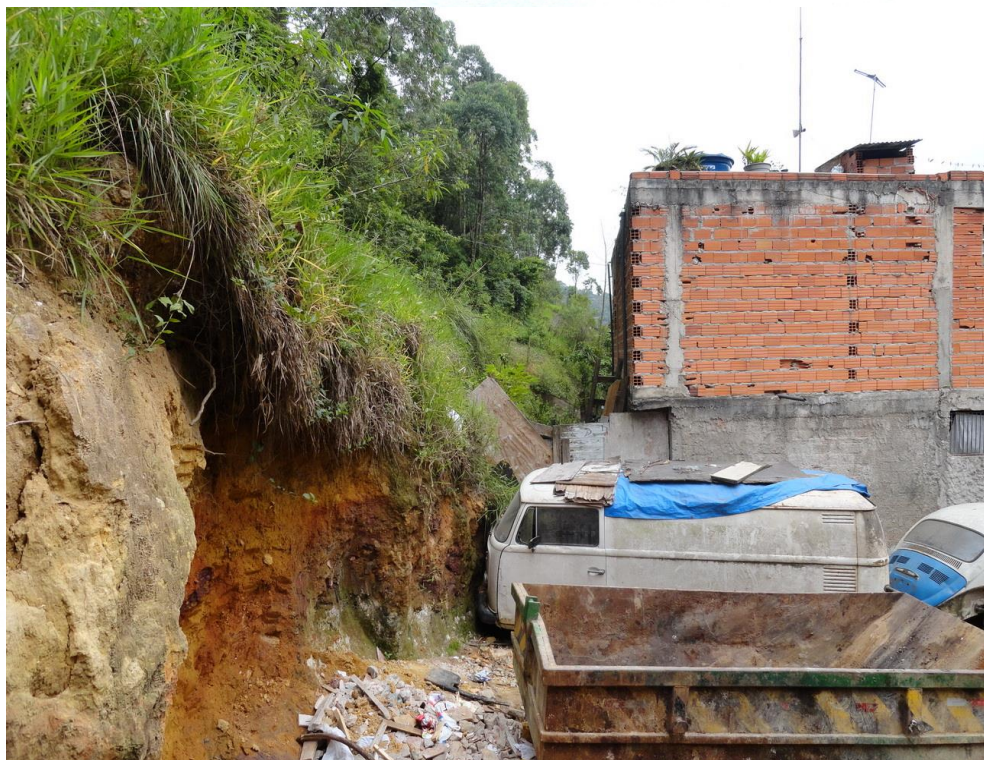
Foto FC-STA-20-04.02: Notar a altura elevada do corte e a proximidade com as moradias localizadas em sua base.
