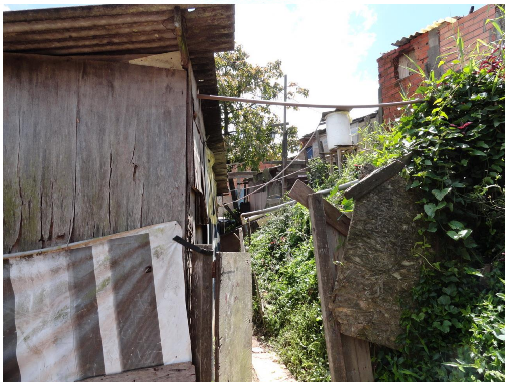
Foto FC-STA-21-01.02: Detalhe da proximidade de uma das moradias de baixo padrão construtivo com relação a base do talude de corte.
