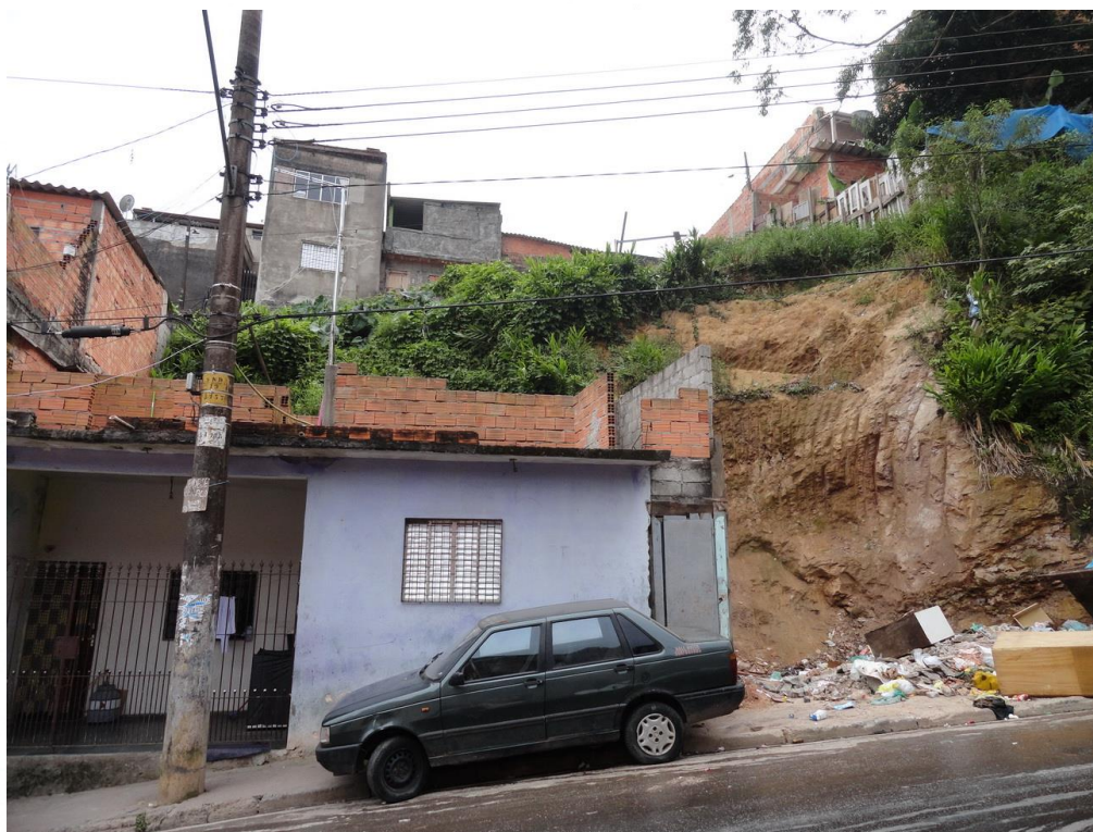
Foto FC-STA-20-02.01: Detalhe do talude de corte com altura e inclinação elevada nos fundos e ao lado de uma das moradias do setor.
