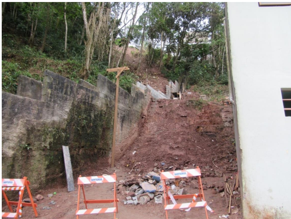
Foto 12. Classe IVA – Consolidação Muito Complexa : Rua Arara Azul - Recreio da Borda do Campo - Santo André
