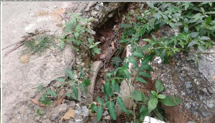
Visão geral da drenagem. Tubulão rompido
