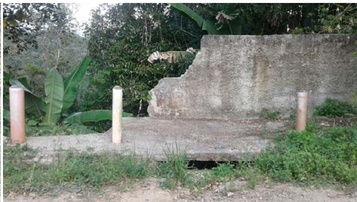
Visão geral da drenagem.
