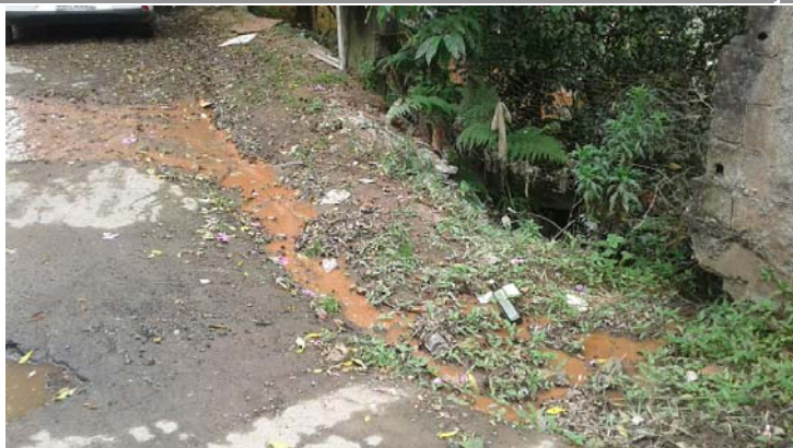
Visão geral da área. Águas servidas caindo na erosão
