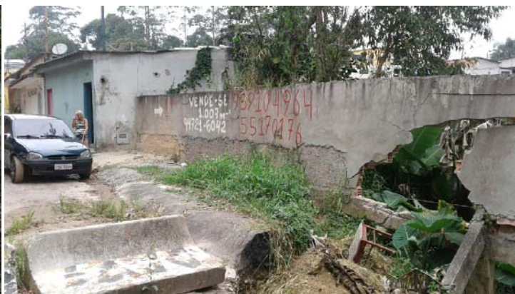
Imóveis afetados pelo processo. Rachadura em imóvel
